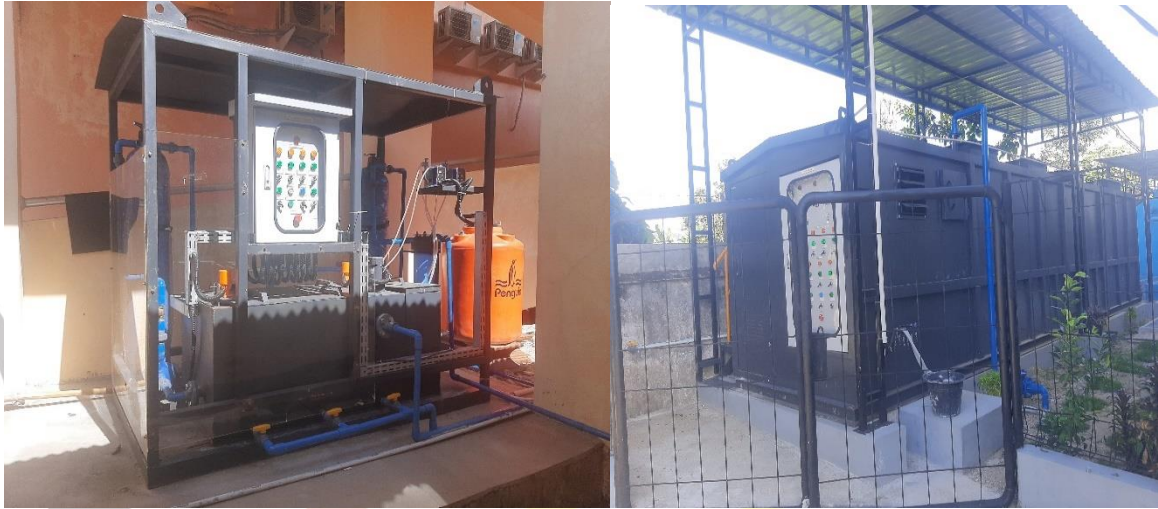
Gambar 12 Instalasi Pengolahan Air Limbah (IPAL)
