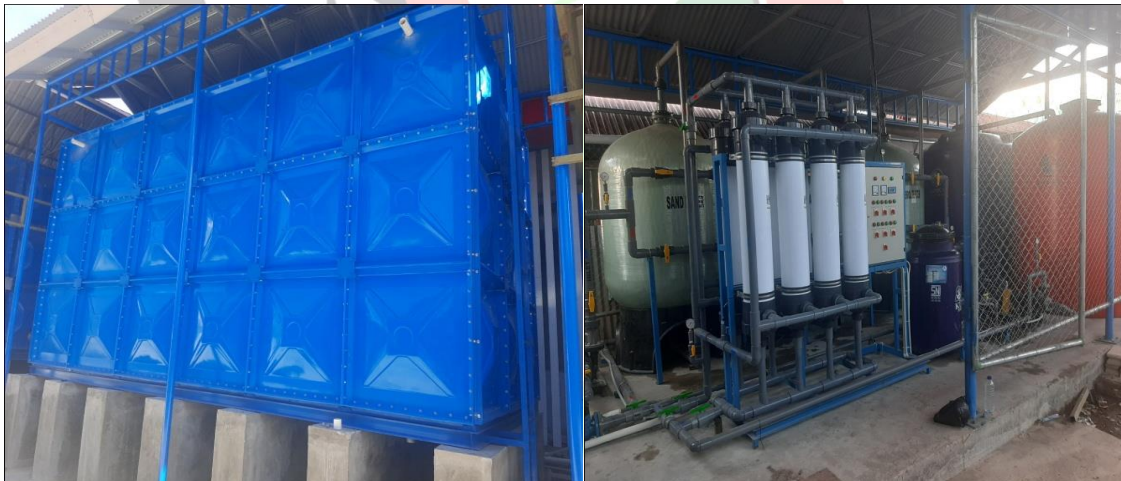
Gambar 13 Instalasi Air Bersih (WTP)
